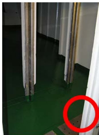
圖 4. 漁艙應維持乾淨且無生鏽之情況，油漆表面不可有造成污染危害起泡或剝落的狀態。
